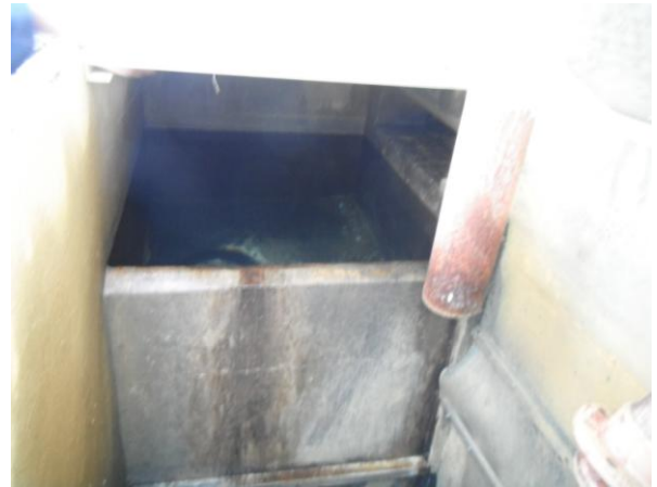
Bassins où transitent les eaux sales provenant du décanteur (1er plan) et des filtres à sables (2nd plan)
