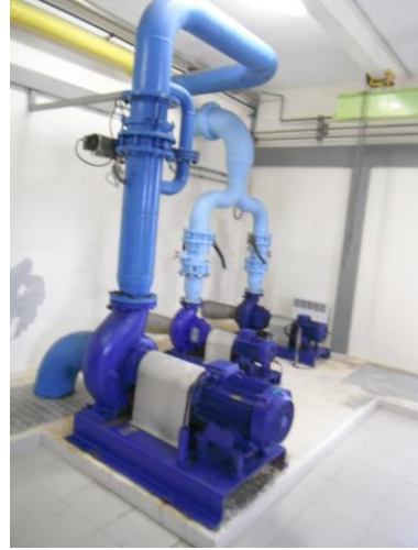
Electropompes de reprise de la bêche de break point vers le filtre à charbon actif
