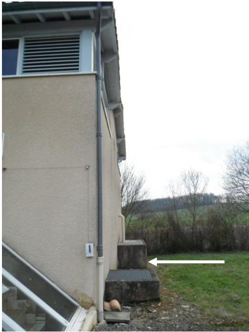
Point de collecte des eaux de rejets pour les filtres à sables et le décanteur
