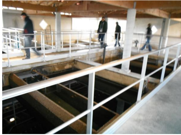
Décanteur au fond et filtres à sables, filtre à charbon actif au premier plan
