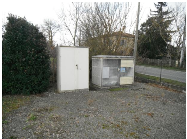
Abri comptage et transformateur
